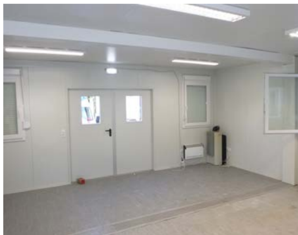
Innenansicht Raumelement Eingangsschleuse LKH Hall
